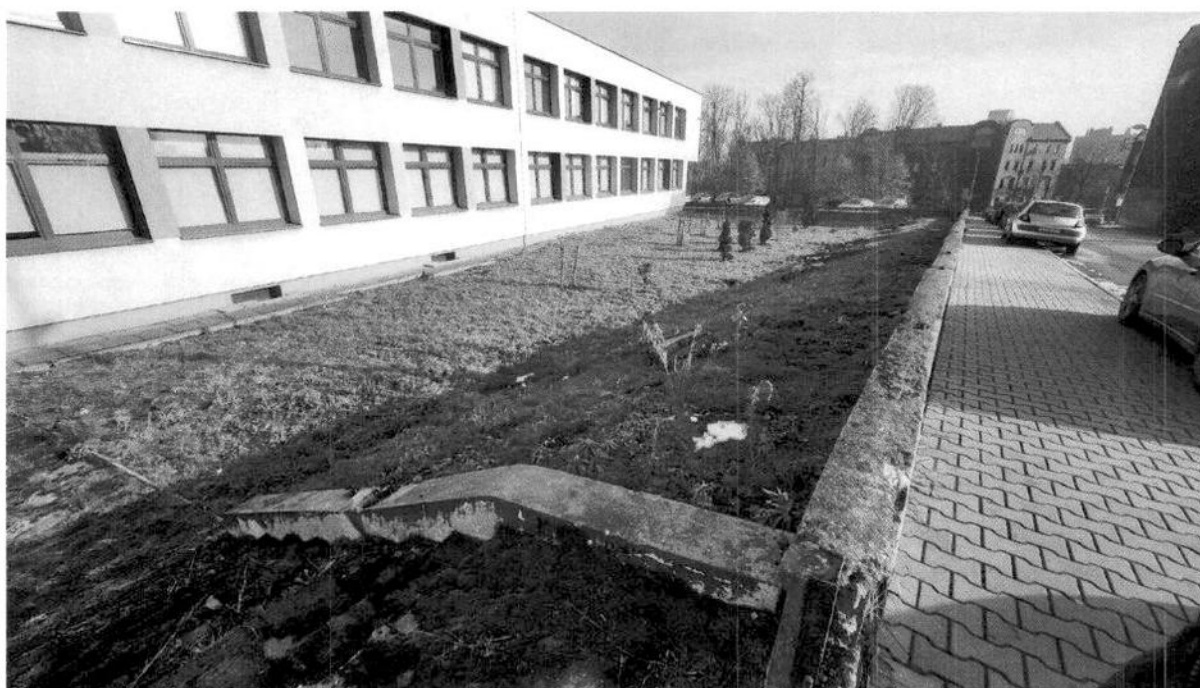
Cokół po ogrodzeniu szkoły
